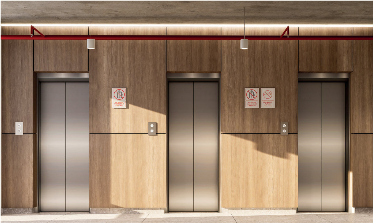
Hall de ascensores
